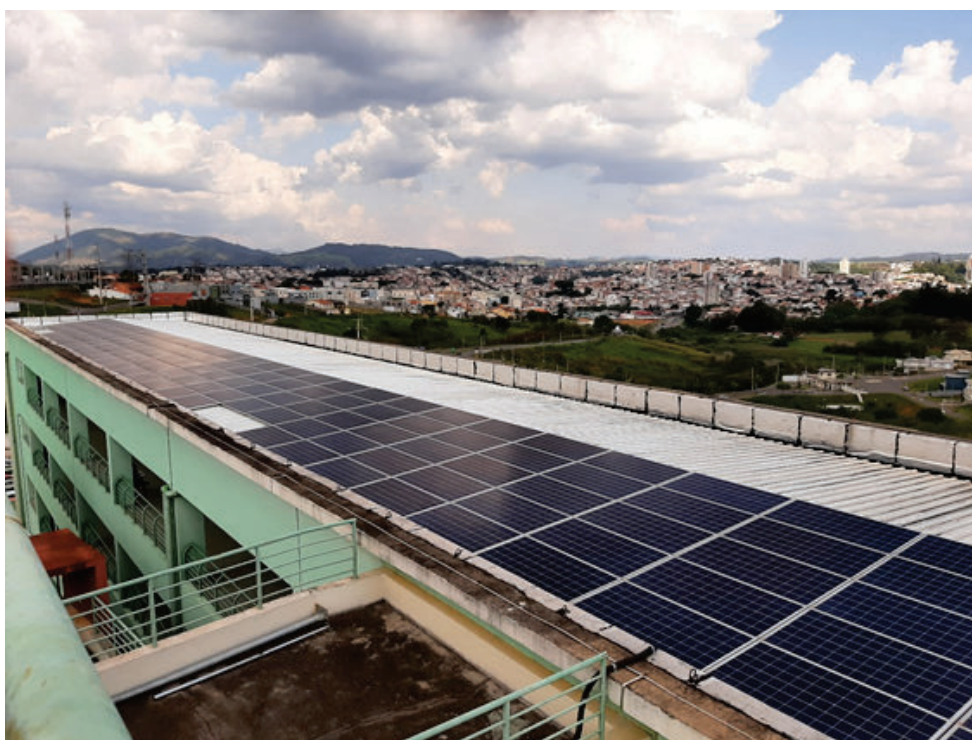
Figura 2 - Imagem das usinas solares fotovoltaicas instaladas no IFSP-BRA
